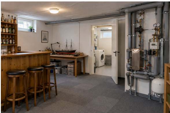
Keller mit Bar und Fernwärme-Übergabestation Musterfoto
