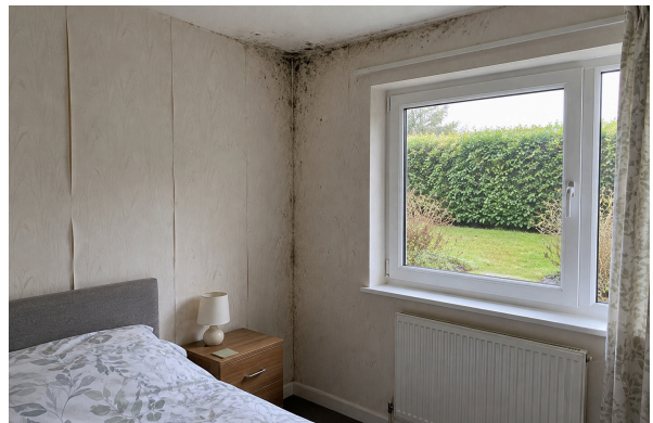
Schimmelbildung an einer Außenwand (Wärmebrücke) Musterfoto
