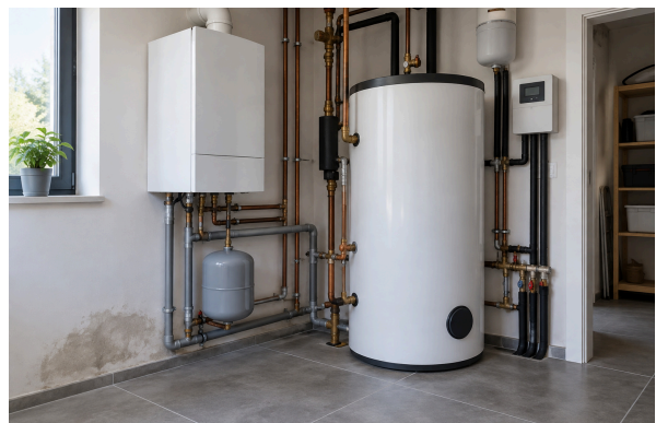
Heizung, Feuchtfleck am Sockel
