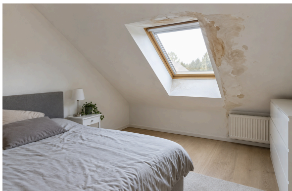
Wasserschaden am Dachflächenfenster
