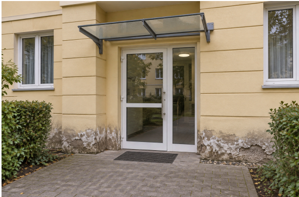
Hauseingang Nr. 12, Feuchteschäden am Sockel
