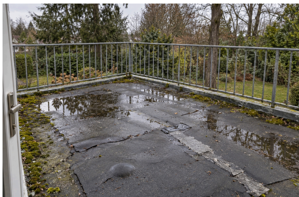
Dachterrasse auf dem Wintergarten (undicht)
