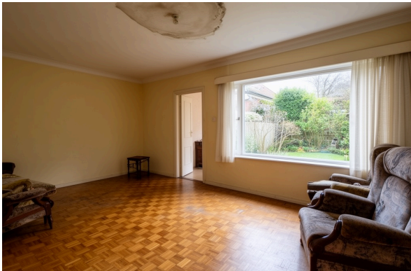
Wohnzimmer (Feuchteschaden an der Decke)
