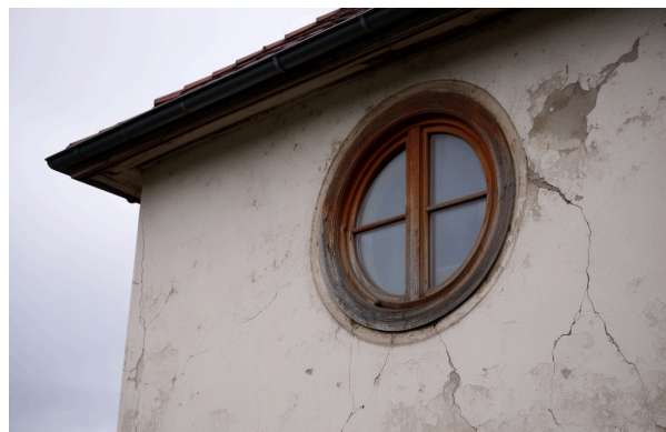
Fassade und Rundfenster (Schäden)
