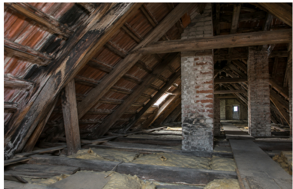
Dachboden mit Verfärbungen
